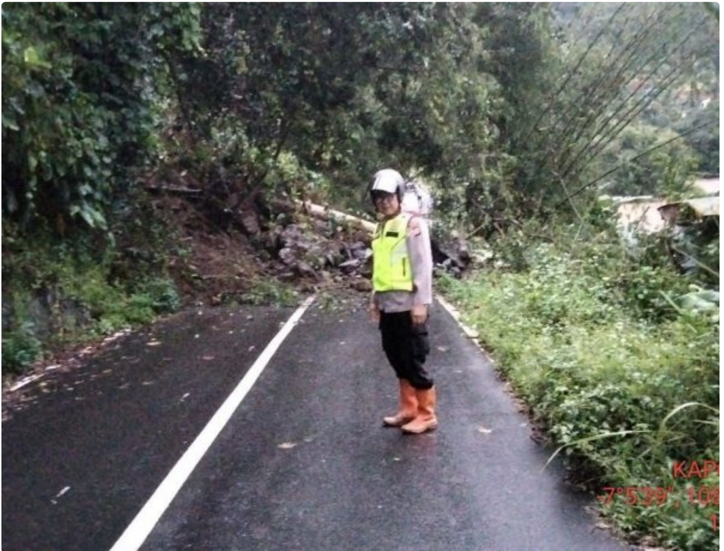
Akses jalan dari Selajambe menuju Darma kembali tertutup Longsor
